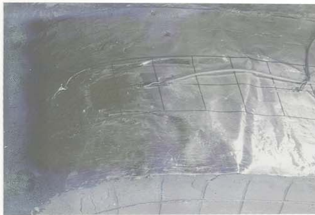
Fig F84 : Rupture de la nappe d'aluminium de fort module et de faible effort de traction à la rupture
