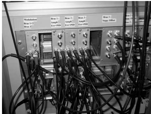
FIG. 5.23 – Photographie du rack contenant toute l'électronique des trois asservissements.
