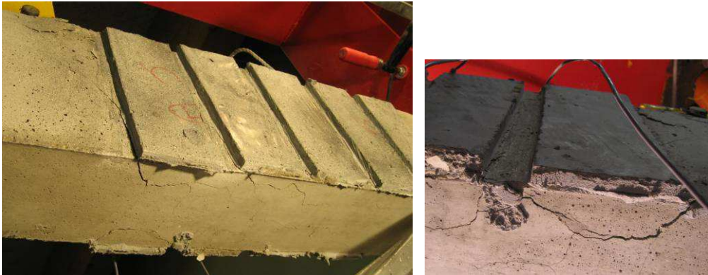
Figure 233 : Poutre « R30-B-FI-P-TRC(10) » après rupture (face inférieure)
