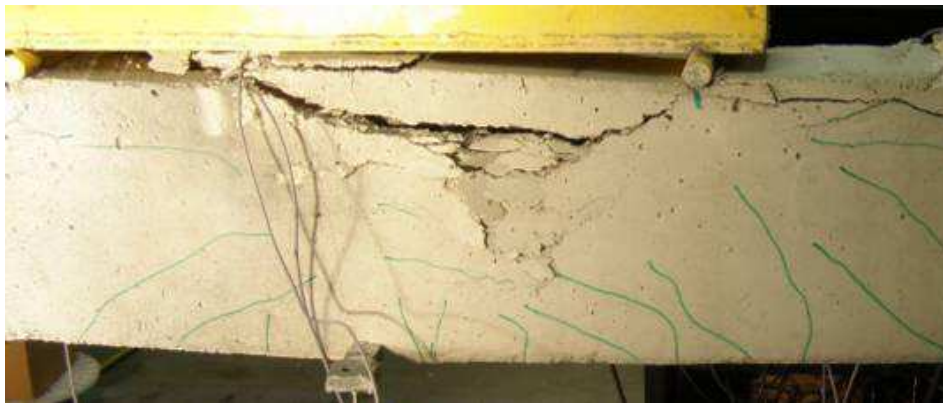
Figure 223 : Poutre « R30-C-U-Is-TRC(5) » après rupture
