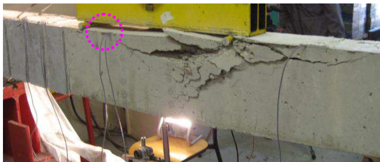
Figure 300 : Illustration du mode de rupture de la poutre « R30-B-FI-P-TRC(10) »
