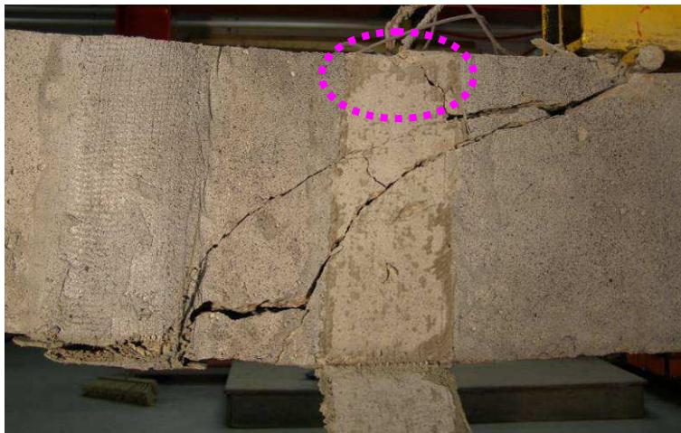
Figure 221: Poutre « R40-B-U-Is-TRC(5) » après rupture
