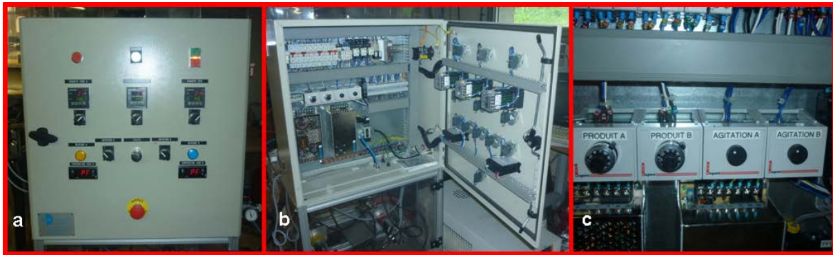
Figure 57 – Vue du tableau électrique (a) face extérieure, (b) intérieur (c) zoom sur les potentiomètres.
