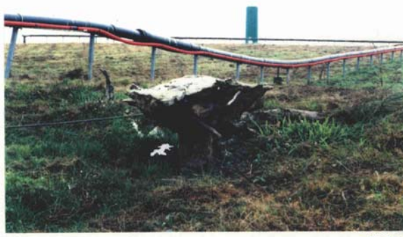
Figure 9.1 Perturbations d'un réseau aérien de drainage des biogaz (Source : Antea)
