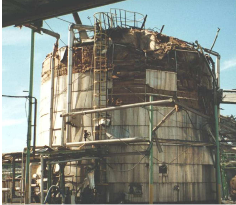
FIGURE 2.4 – Toit de réservoir enfoncé.
