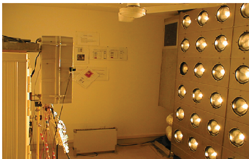
Figure II.10b. Salle d'essais d'armoire de télécommunication.
