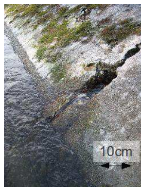
(a) Fuite récurrente, repérée à la jonction de deux dalles du contre-canal juste à l'amont du tronçon d'étude
