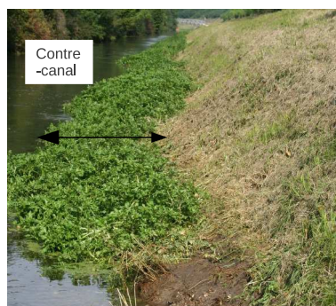
FIGURE 6.2.7: Photographie du pied de talus aval, la végétation gêne l'examen visuel pour la détection des fuites à ce niveau.
