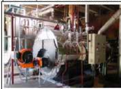
Photo 2 : chaudière biogaz à l'usine
