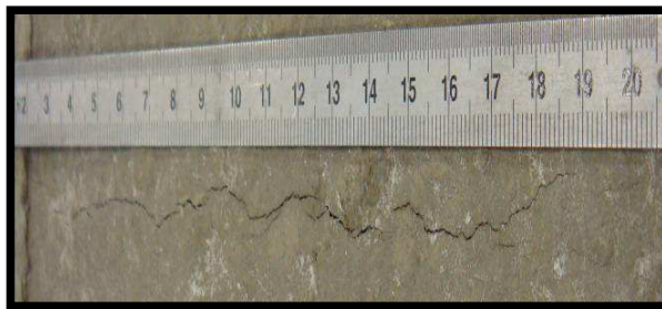
Figure I-48 : Fissure de retrait de plastique.
