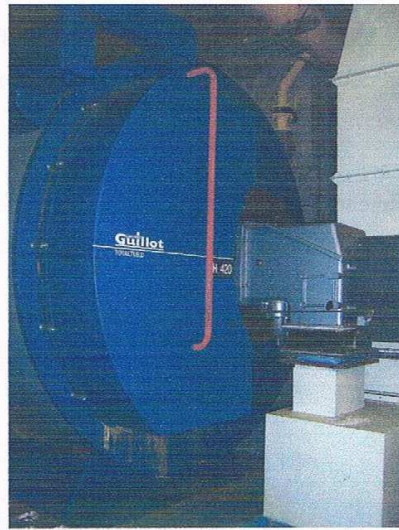
2007- Une des chaudières GUYOT – Photo JCL
