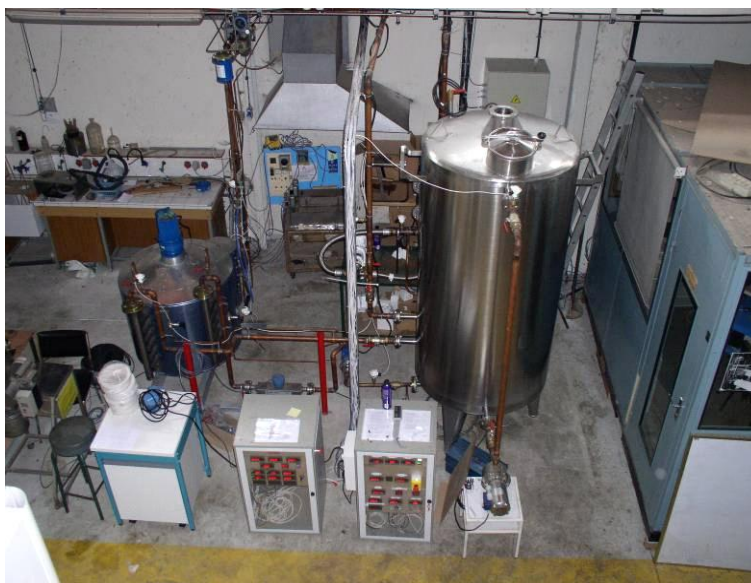
Figure 211 L'installation initiale (générateur, cuve de stockage et centrales d'affichage des capteurs)
