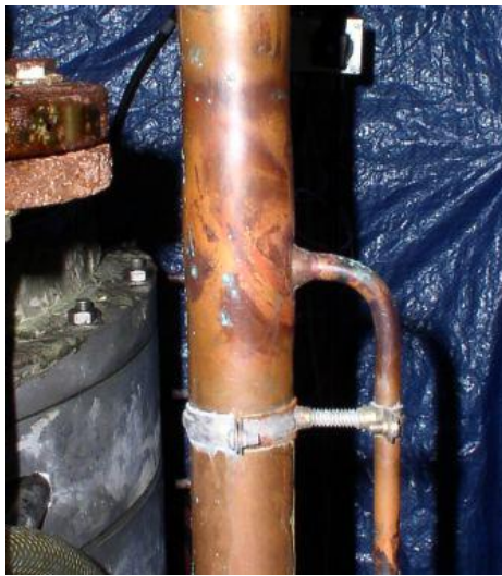
Figure 147 Observation de la déformation de la tuyauterie
