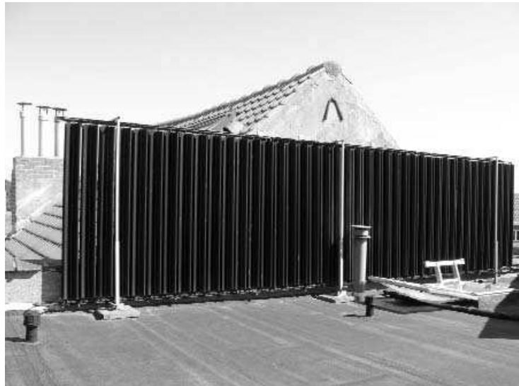
Figure II-2 : Photo d'un échangeur à air statique sur une toiture [Huart 2006].
