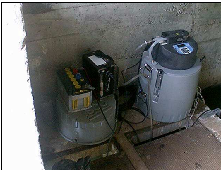
Photo I. 8 – Préleveur automatique à la source du Hannetôt (ancien captage).
