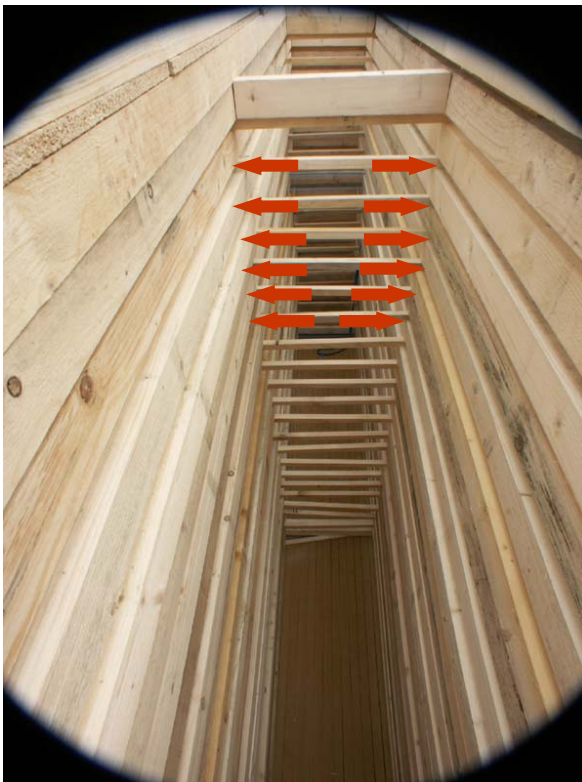
Fig. 52 – La poussée horizontale est reprise en traction par les petites tiges de bois qui traversent le mur : sans elles, tout s'effondre.
