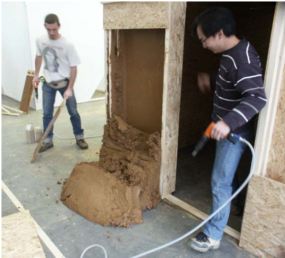
Fig. 13 – Au décoffrage, la terre, toujours humide, s'effondre. D'après Le Tiec (2005).
