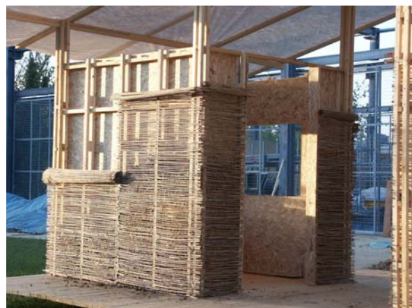
Fig. 26 – Canisse de roseau déroulée et agrafée sur l'ossature, servant de coffrage perdu. D'après Le Tiec (2005).
