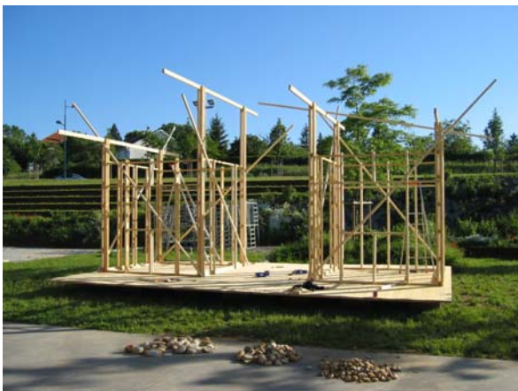
Fig. 7 – Des contreventements provisoires permettent de stabiliser la structure pendant le chantier. D'après Le Tiec (2005).
