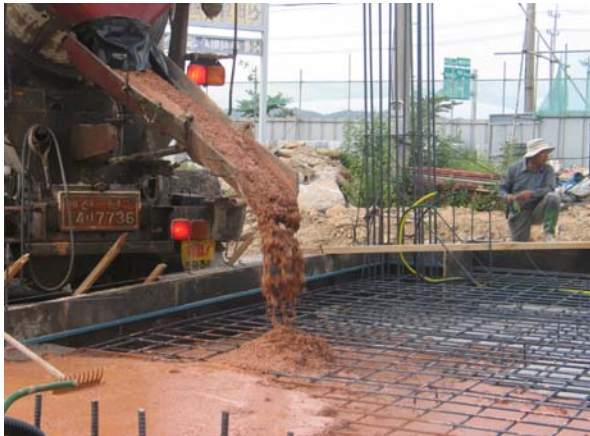
Fig. 9 – Pour la réalisation de cet édifice, la terre est amenée sur le chantier par un camion toupie. Elle est ensuite versée dans un coffrage dans lequel est inséré un ferrailage à béton. Photo : Heeyong Choi/Mokpo National University.
