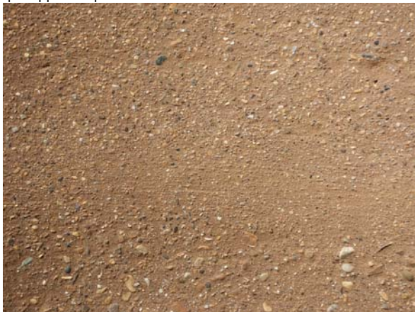
Fig. 33 – Pour le système à coffrage rampant, la terre est simplement brossée avec de l'eau, pour boucher les grosses porosités tout en faisant apparaître les granulats. La texture rappelle celle du pisé. D'après Le Tiec (2005).
