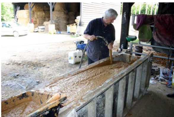
Fig. 3 – Le matériau est mis en place avec les mêmes outils utilisés pour le coulage du béton de ciment. Une aiguille vibrante permet ici de compacter le matériau.
