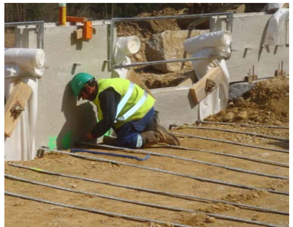
Fig. 92 – Les tirants métalliques sont fixés sur les écailles en béton. Photo : Terre Armée SAS, Laurent Hujeux.
