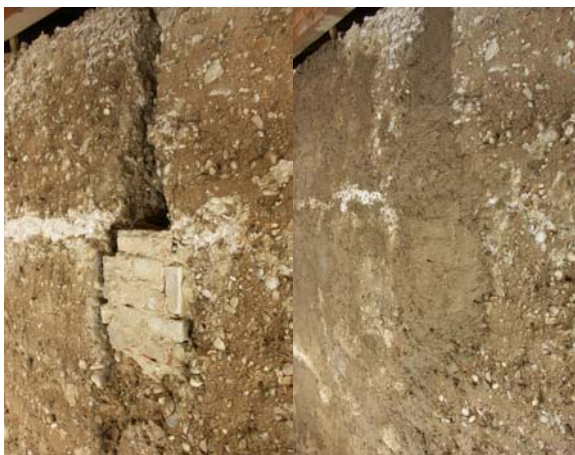
Fig. 34 – Le même matériau peut être utilisé sur des chantiers de restauration. D'énormes fissures sont rebouchées avec ce béton d'argile qui ne s'affaisse pas. D'après Le Tiec et Paccoud (2006).
