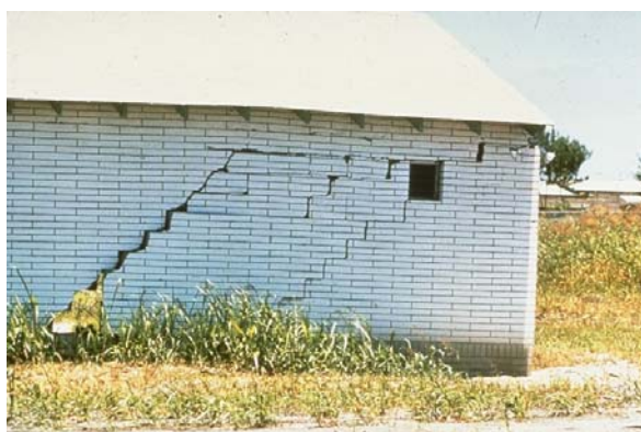
Fig. 43 – Apparition de larges fissures dans un mur en briques en raison du mouvement du sol, riche en smectite. http://soils.cals.uidaho.edu/soilorders/i/Vert_08b.jpg
