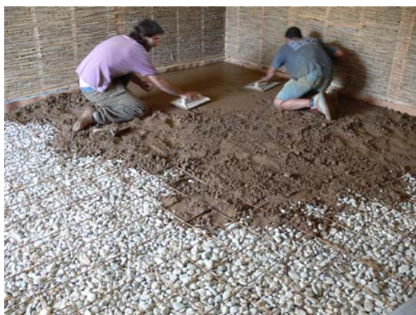
Fig. 8 – Première dalle en terre coulée non stabilisée réalisée avec ajout d'un dispersant (hexamétaphosphate de sodium). La fluidité obtenue est moyenne, mais suffisante pour que le matériau puisse être mis en œuvre à la taloche.
