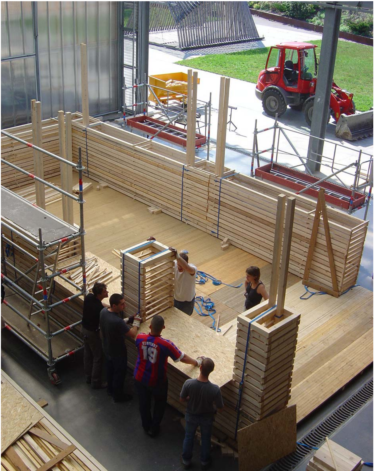
Fig. 43 – Ce premier prototype a été réalisé aux Grands Ateliers par 6 étudiants en l'espace de quelques heures. D'après Porte (2005) .
