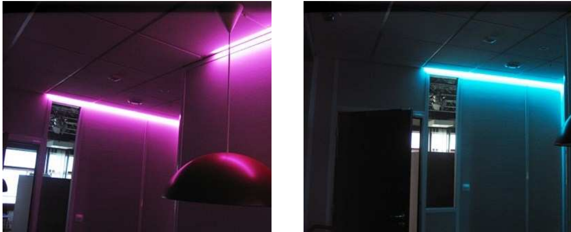
Figure 5-16. Exemple d'éclairage d'ambiance dans la cuisine de l'appartement Domus
