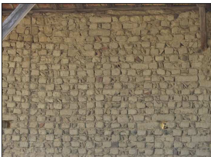
Fig. 89. - Mur élevé en appareillage en damier associant terre crue et galets dans le village de Mont-d'Astarac.
