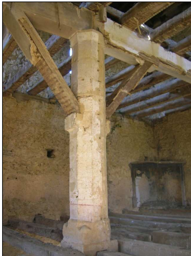
Fig. 69. - Photographie du pilier central de la salle du Capitou (commune de Barran) soutenant la poutre maîtresse du plancher du deuxième étage à l'aide d'aiseliers.
