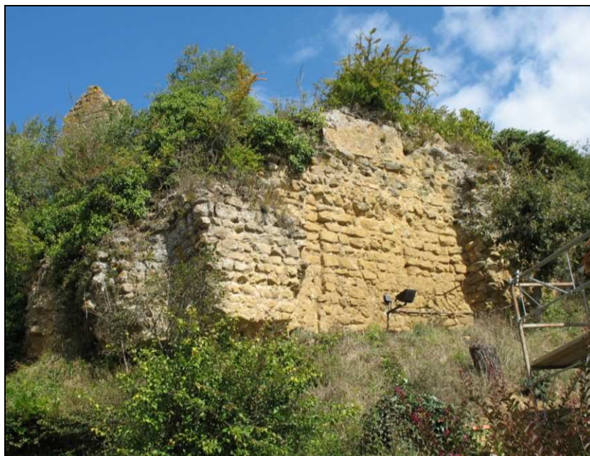
Fig. 43. - Vue générale de mur méridional extérieur de la tour à contreforts de Durban.
