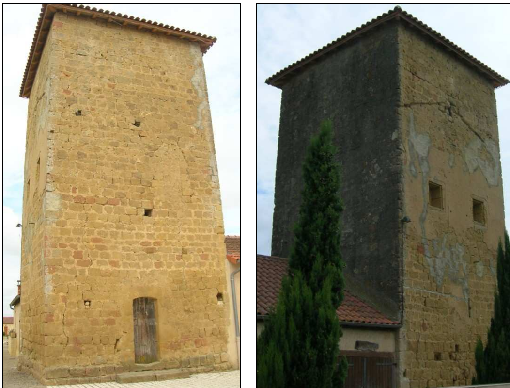
Fig. 64. - Photographies de la façade orientale de la tour de Miramont-d'Astarac avec porte rebouchée au premier étage (à gauche) et de la façade méridionale présentant divers aménagement d'un habitat attendant (à droite).
