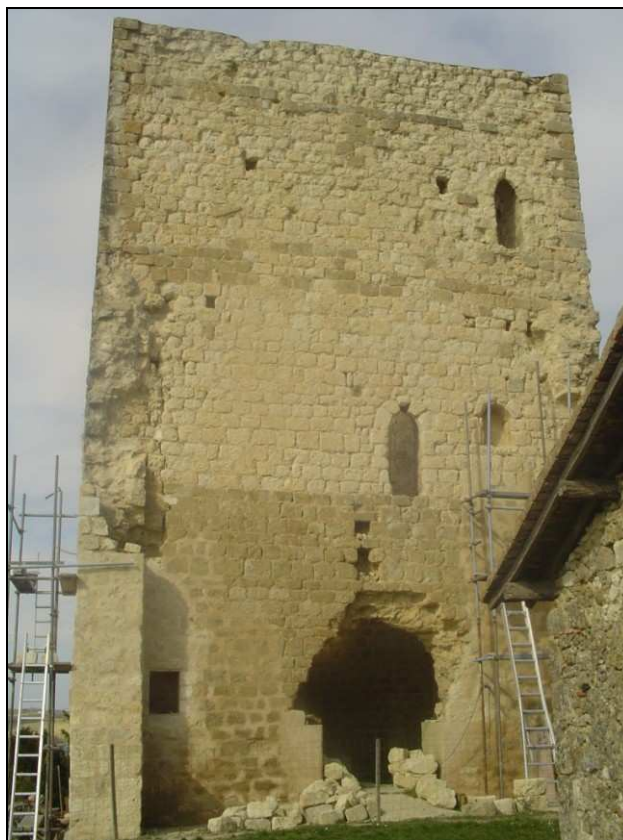
Fig. 75. - Photographie de la façade sud-est de la tour de Lagouarde (commune de Lartigue) avec traces d'arrachement des murs appartenant à la salle attenante disparue.
