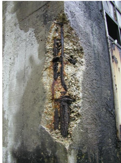
Figure 2 : Photographie d'un parement présentant une armature métallique mise à nu, Soufflerie de l'ONERA, Meudon
