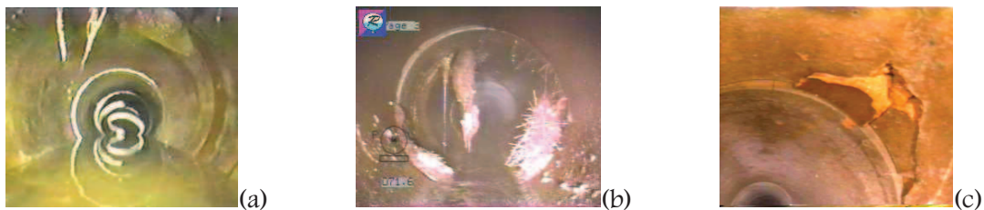
Figure 1.1. : Prises de vue lors de l'inspection intratubulaire de canalisations industrielles : présence d'eau (a), développement d'obstacles (b), dégradation (c) [R&RV-01]
