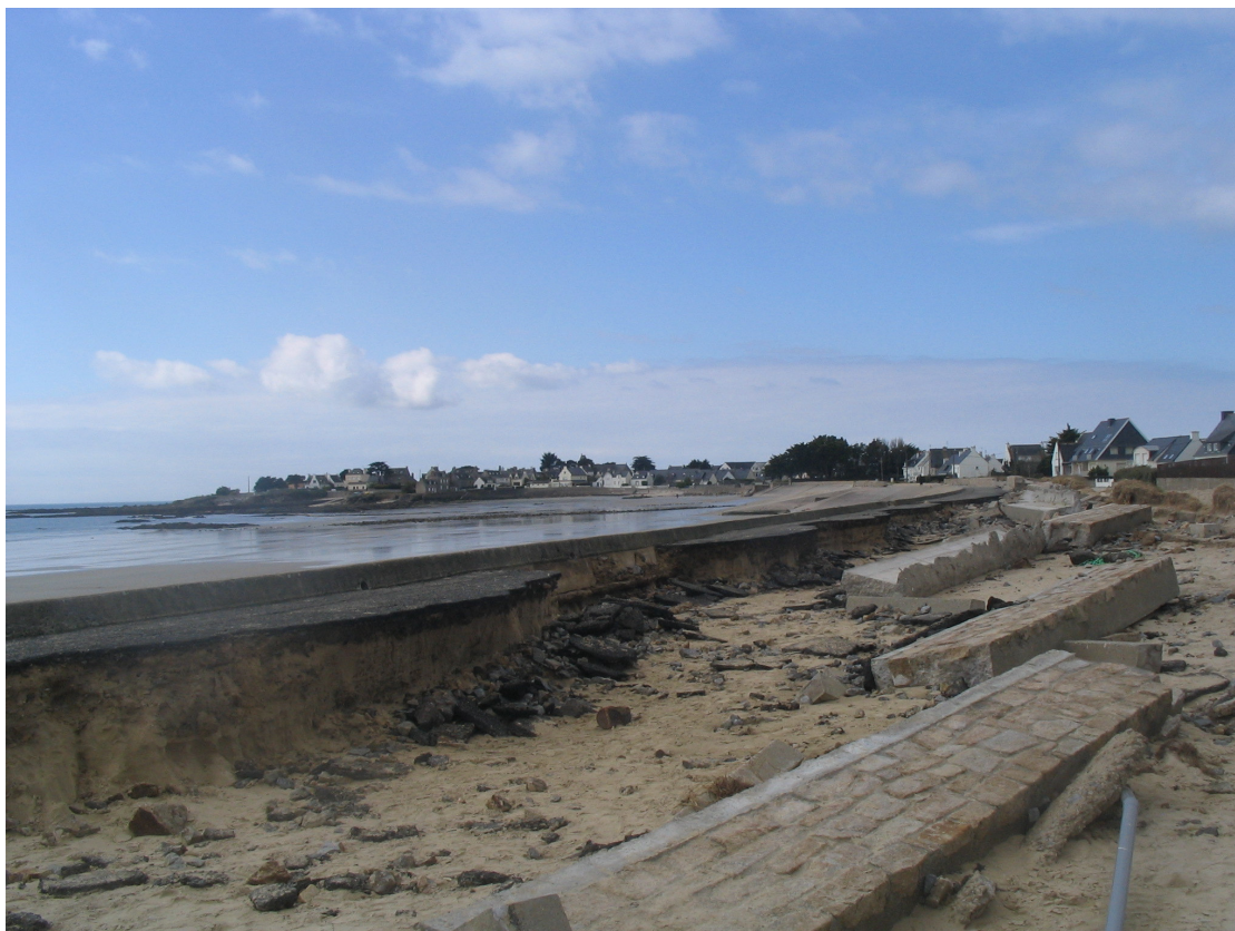
Photo A.1: Rupture d'un mur de défense contre la mer à Gâvres lors de la tempête du 10 Mars 2008. Photographie prise le 15 Mars 2008.
