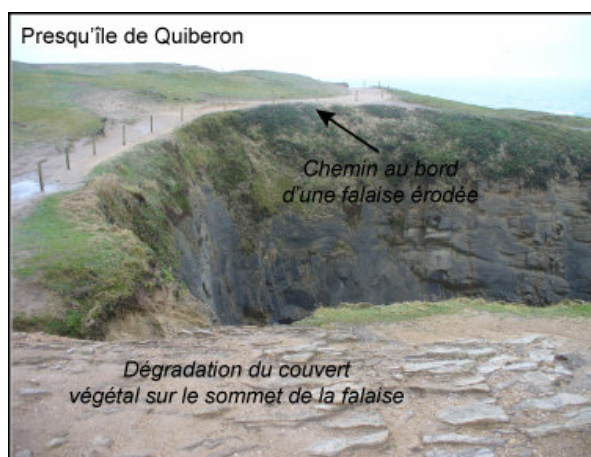
Photo II.2 : Recul des falaises de la côte Sauvage de Quiberon associée à la présence d'un chemin et d'une dégradation de la couverture végétale (Février 2008)
