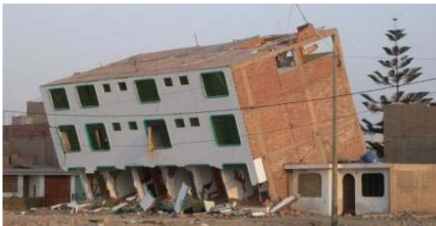
Photo n°18 : Bâtiment effondré à Pisco
