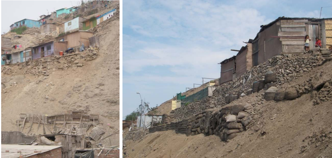
Photos n°75 et 76 : Remblais précaires en pierres sèches et en pneus soutenant des maisons sur les pentes du Cerro à Villa Maria El Triunfo et de l'Agustino Source : J. Robert, 2009
