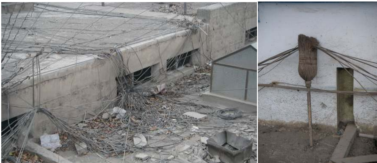
Photos n°51 et 52 : Câbles électriques sur le toit de l'hôpital Sergio Bernales (Minsa). Source : J. Robert, 2010
