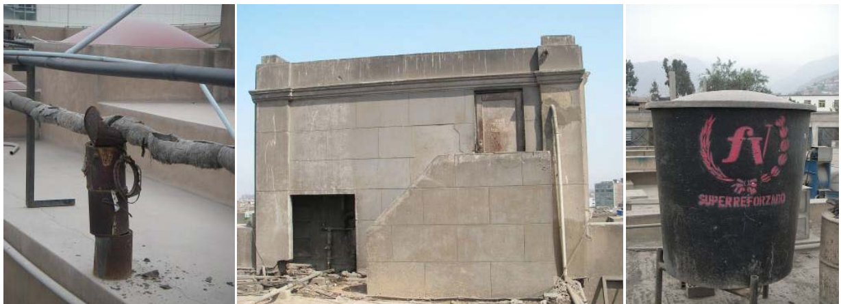
Photos n°53, 54 et 55 : Canalisation soutenues de façon précaire au Sabogal (EsSalud) ; réservoirs d'eau en dur pour le Loyaza et réservoirs plus légers pour le Sergio Bernales (Minsa). Source : J. Robert, 2010
