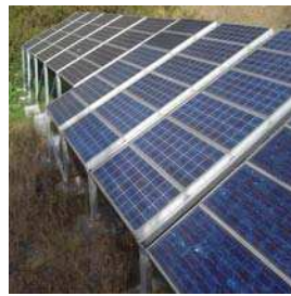
(b) Installation photovoltaïque en site isolé (Marla, Réunion). Source : fr.academic.ru
