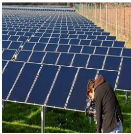
(a) Ferme photovoltaïque. Source : www.energiegratuite.biz
