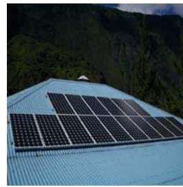
(c) Installation photovoltaïque en toiture (Réunion). Source : www.hallou-solaire.com
