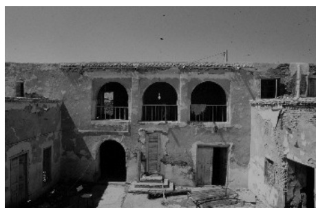
Vue vers la sgîfa (à gauche) et la pièce 4 (à droite), et les pièces 14-15-16 à l'étage
