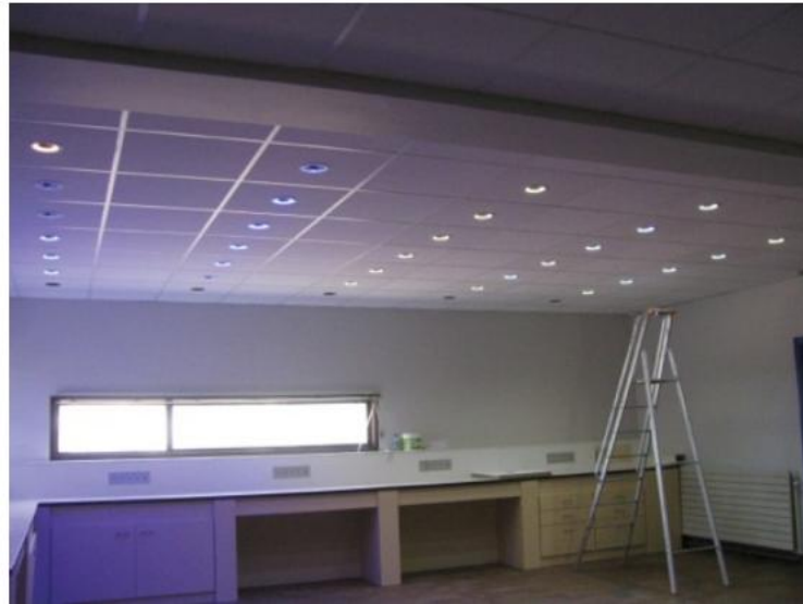
Figure 122 : Installation des luminaires Luxspaces équipés des différents disques de luminophores à tester
