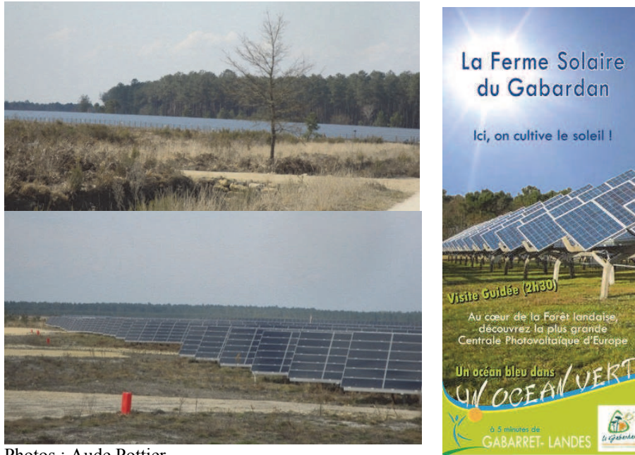
Figure 28 : Centrale photovoltaïque du Gabardan
