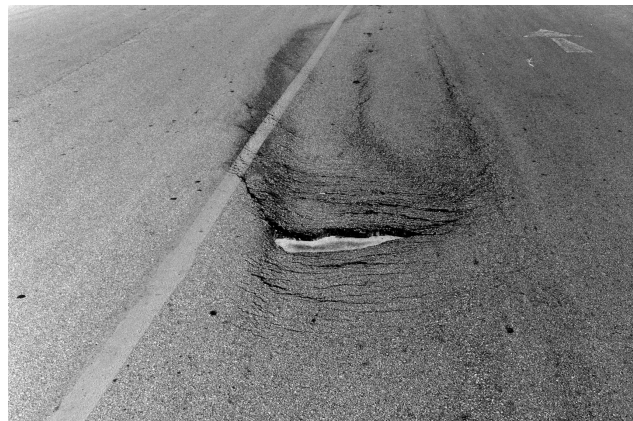
FIGURE 1.25 – Glissement de fissuration causé par la mauvaise adhérence d'interface
