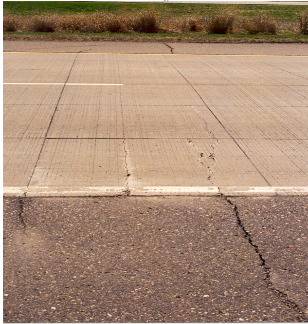
FIGURE 1.23 – Fissure réfléctive à travers la couche de BMC [Burnham, 2005]
