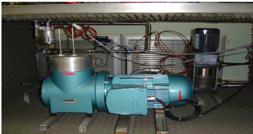
Figure B 5: Compresseur de recirculation
