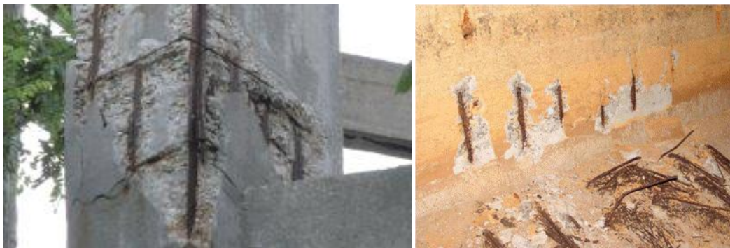
Figure 18 Photos de dégradations provoquées par la formation de produits expansifs (NGUYEN 2007).
