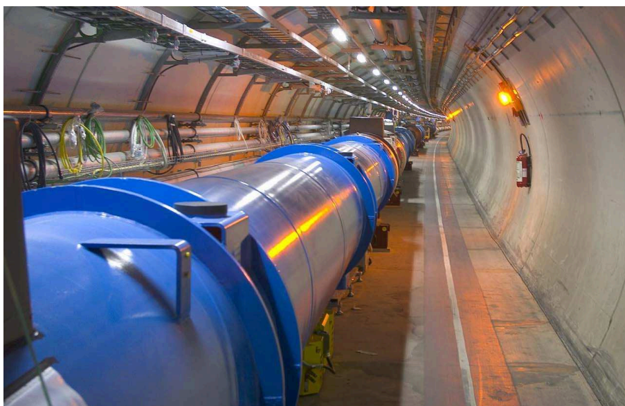
FIG. 2.4 – Les cryodipôles dans le tunnel du LHC
