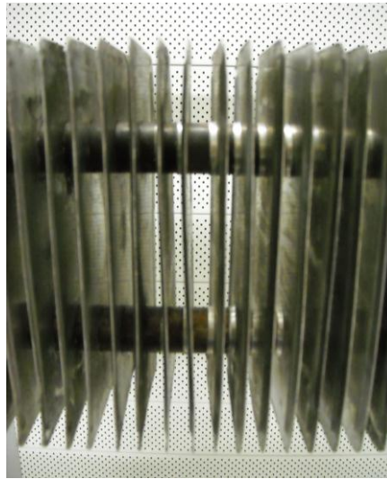
Figure 4.2. Illustration du défaut d'écartement entre les ailettes.
