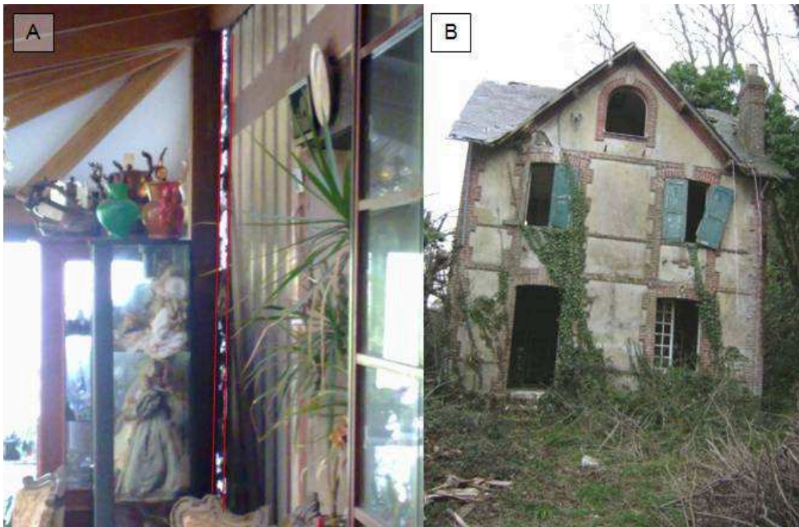
(A) Villa du ‘Clos Marin’ au Fosses du Macre avec fissure d’environ 4 cm qui progresse à chaque accélération saisonnière, (B) Villa basculée abandonnée en amont du glissement d’ Hennequeville .
