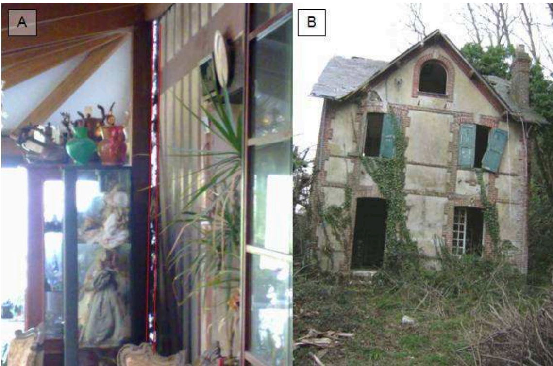
(A) Villa du ‘Clos Marin’ au Fosses du Macre avec fissure d’environ 4 cm qui progresse à chaque accélération saisonnière, (B) Villa basculée abandonnée en amont du glissement d’ Hennequeville .
