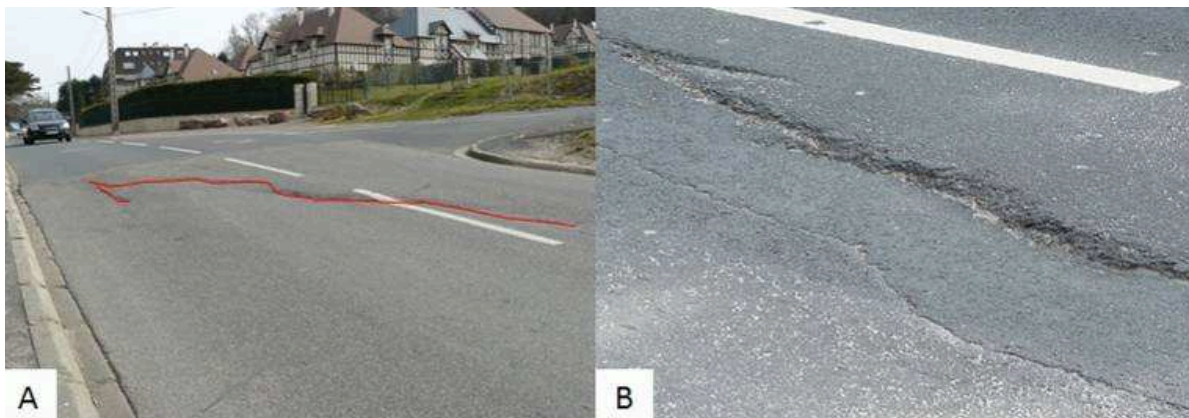
Figure 2-17. Fissures ouvertes et affaissement de la RD 513 au droit du glissement du Champ des Oiseaux à Trouville-sur-Mer (A), et du glissement du Cirque des Graves à Villerville (B).
