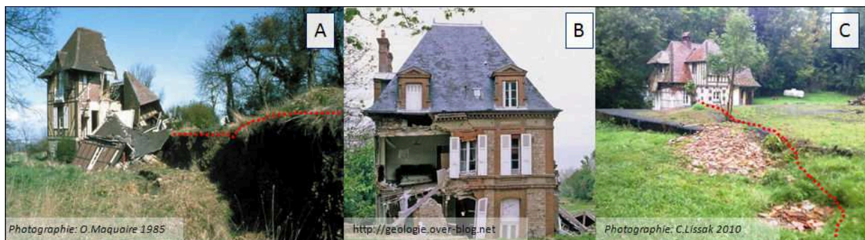
Figure 1-3. Aperçu des dommages structurels provoqués lors de l'accélération 1982 sur la villa Chanteclair (A), de l'accélération 1982 sur la villa Cheval de Brique 1982 (B), et de l'accélération de 1995 sur la propriété du Pré de l'Aumône (C) (localisation des villas sur la figure 2-19).
