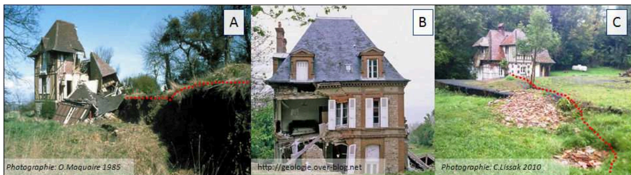
Figure 1-3. Aperçu des dommages structurels provoqués lors de l'accélération 1982 sur la villa Chanteclair (A), de l'accélération 1982 sur la villa Cheval de Brique 1982 (B), et de l'accélération de 1995 sur la propriété du Pré de l'Aumône (C) (localisation des villas sur la figure 2-19).
