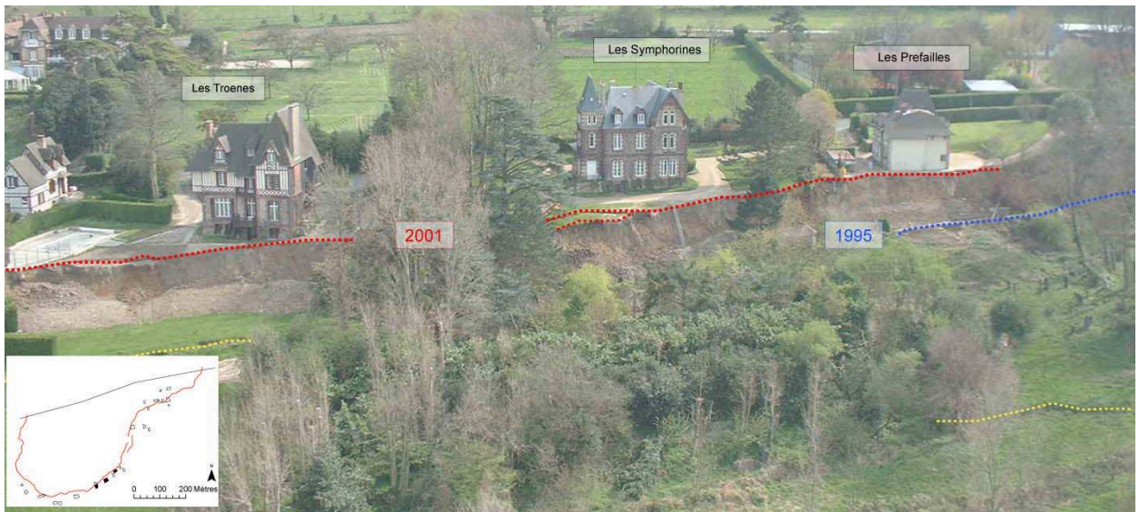
Figure 6-19. Positions de l'escarpement principal en 1995 et 2001 au droit des propriétés Les Troènes, Les Symphorines et les Préfailles du glissement des Fosses du Macre à Cricqueboeuf (Photo : DREAL Basse-Normandie, avril 2001).
