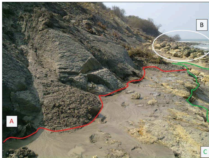
(A) Affleurement de marnes bleues grises, (B) Blocs de craie émoussés provenant du versant et s'accumulant en haut de plage, (C) Écoulements boueux issus des marnes à la suite d'un épisode pluvieux et recouvrant les grès de l'Oxfordien.
