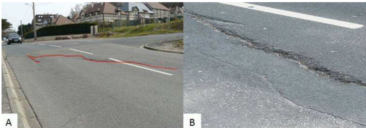
Figure 2-17. Fissures ouvertes et affaissement de la RD 513 au droit du glissement du Champ des Oiseaux à Trouville-sur-Mer (A), et du glissement du Cirque des Graves à Villerville (B).
