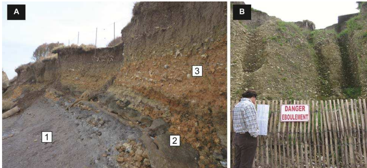
(A) Escarpement basal du glissement des Fosses du Macre où sont visibles (1) Marnes grises, (2) Sables verts glauconieux, (3) Colluvions de fragments siliceux plus ou moins grossiers (type 'head'), (B) Formations superficielles quaternaires (head, sables, limons) au droit du bourg de Villerville.
