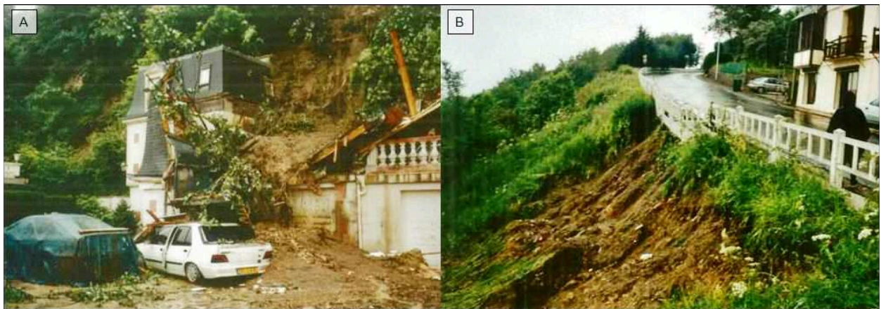
Figure 1-5. Glissements de terrain sur la commune de Trouville-sur-Mer déclenchés suite aux orages du 1 er juin 2003 (source : Lebreton, 2003). (A) Glissement au lieu-dit "Les Creuniers", en amont du glissement de Hennequeville, (B) Glissement superficiel déclenché à l'est du glissement du Chant des Oiseaux.
