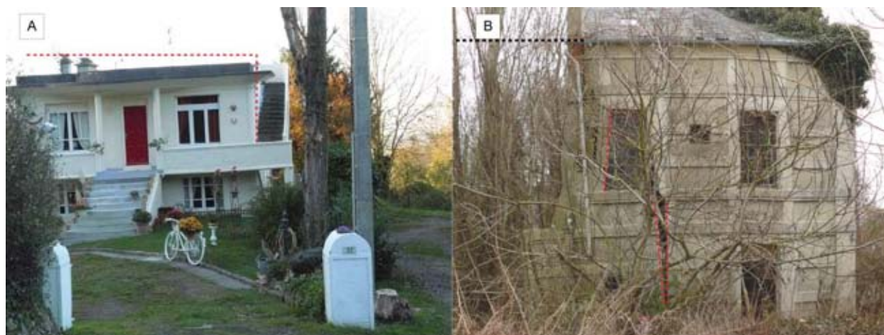
(A) Basculement progressif de la villa du ‘Clos Sainte Thérèse’ au Cirque des Graves, (B) Villa ‘La Colline’ fortement lézardée lors de l’accélération de mars 2001 du glissement des Fosses du Macre.
