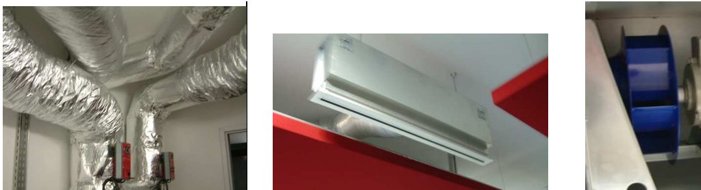
Figure 49. Des composants du circuit aéraulique de PREDIS
