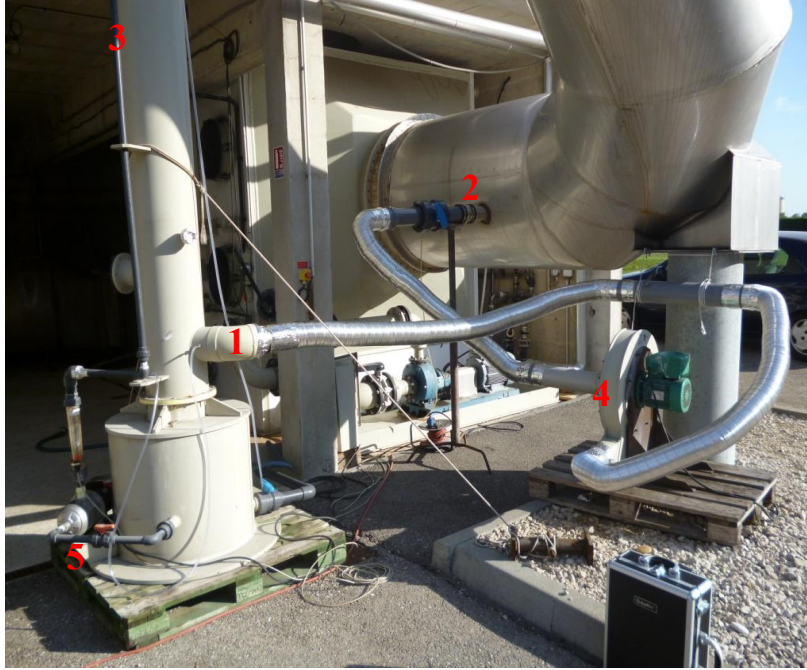
Figure 39 : Implantation du filtre percolateur en amont du couplage de procédés : lavage chimique/ biofiltration. 1 : Entrée filtre percolateur ; 2 : connexion avec la gaine canalisant l'effluent gazeux pollué vers le couplage laveur chimique/biofiltre; 3 : Sortie filtre percolateur ; 4 : Turbine ; 5 : pompe de recirculation de la phase aqueuse.
