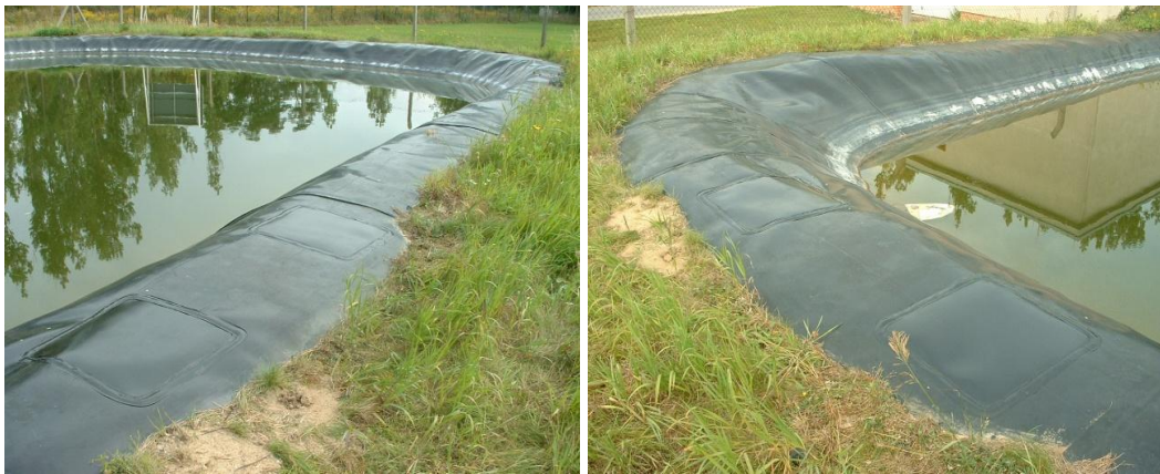
Figure V-1 : Bassin de stockage d'eau avec la zone de prélèvement supérieure exposée aux UV (GMB A).
