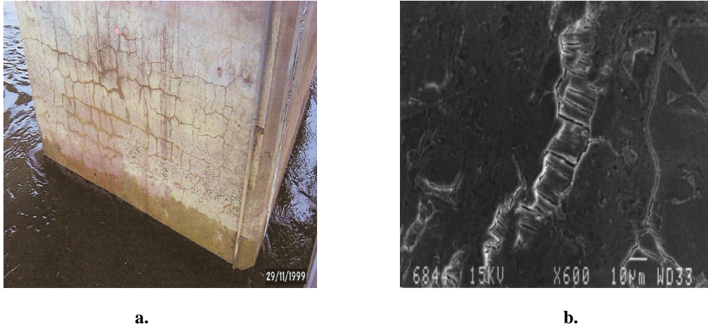
Figure I.3 : manifestations de la RSI : réseau de fissures (a) (échelle macroscopique), veine d'ettringite de formation différée (b) (échelle microscopique)
