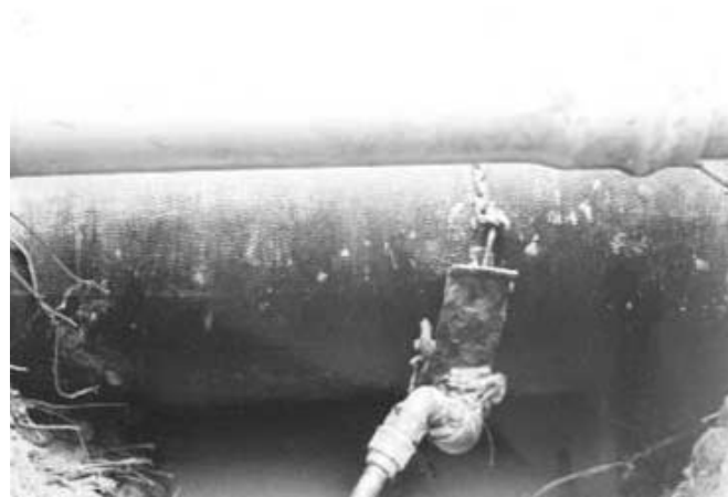
Connexion illégale aux conduites principales
