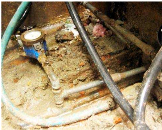
Deux réseaux parallèles
