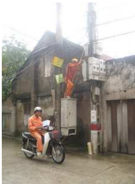
Relevé des compteurs à Yen So
