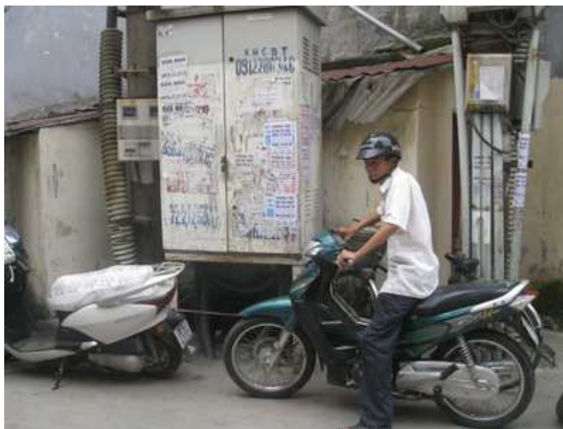
Figure 85. Transformateur Linh Quang 3 – ruelle Linh Quang, quartier Van Chuong
