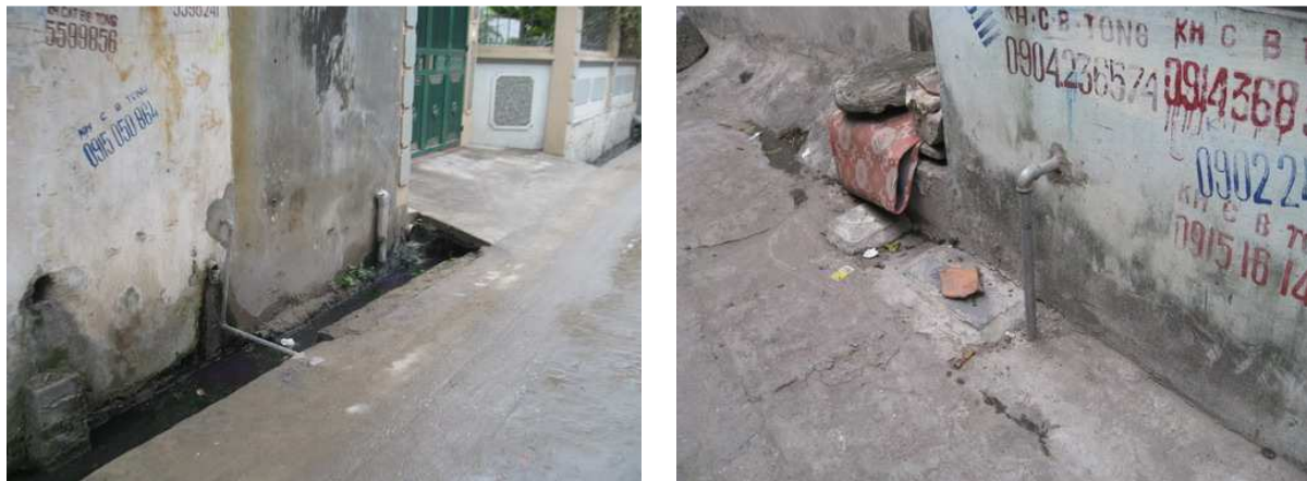
Figure 65. Compteurs de l'eau en dehors de la maison
