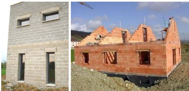
FIGURE 1.20 – Constructions contemporaines en agglos (à gauche) et en briques de terre cuite (à droite)
