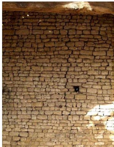
FIGURE 1.13 – Alignement de joints verticaux : coup de "sabre"
