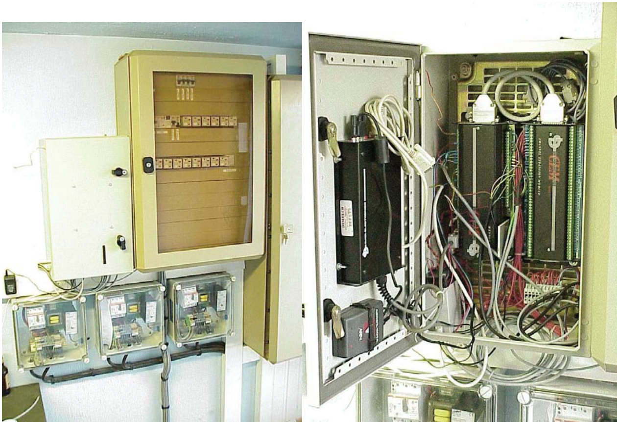
[a] Figure 64 : Armoires électriques [a] et centrale d'acquisition [b]
