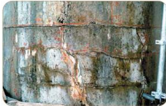
Figure I-4 : Ouvrage endommagé par l'attaque sulfatique interne (formation différée d'ettringite) [LCPC, 2007]
