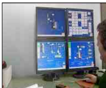
Photo 144 – Salle de contrôle
