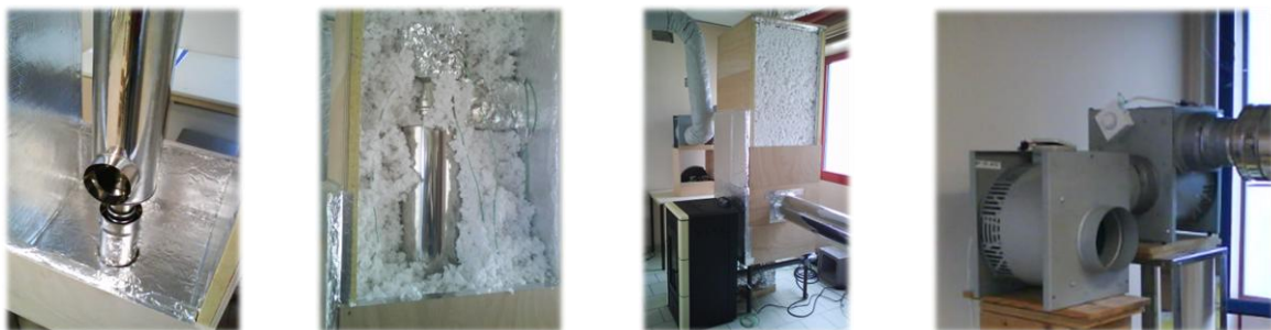
Figure 2.18 : Vues de l'isolation du conduit échangeur et de l'association en série des ventilateurs
