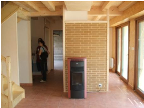
Poêle à granulés de bois 6 kW adossé à un mur de briques d'argile
