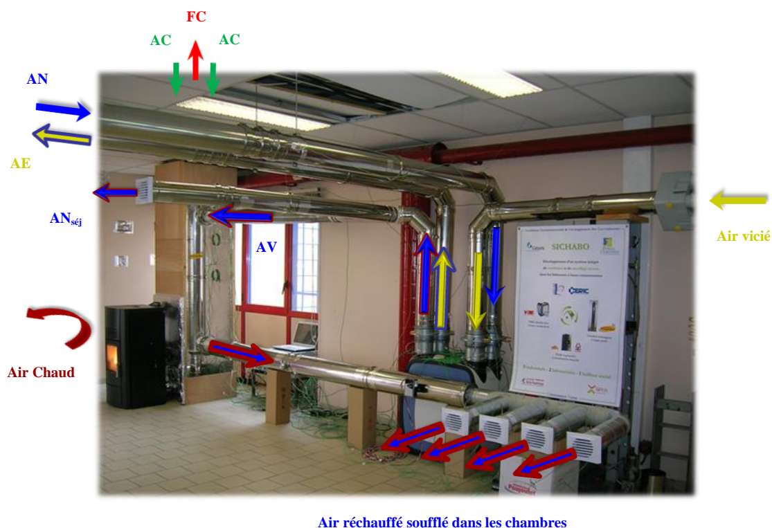
Figure 3.31 : Vue du banc d'essai du système combiné équipé du CETP-NI n°4
