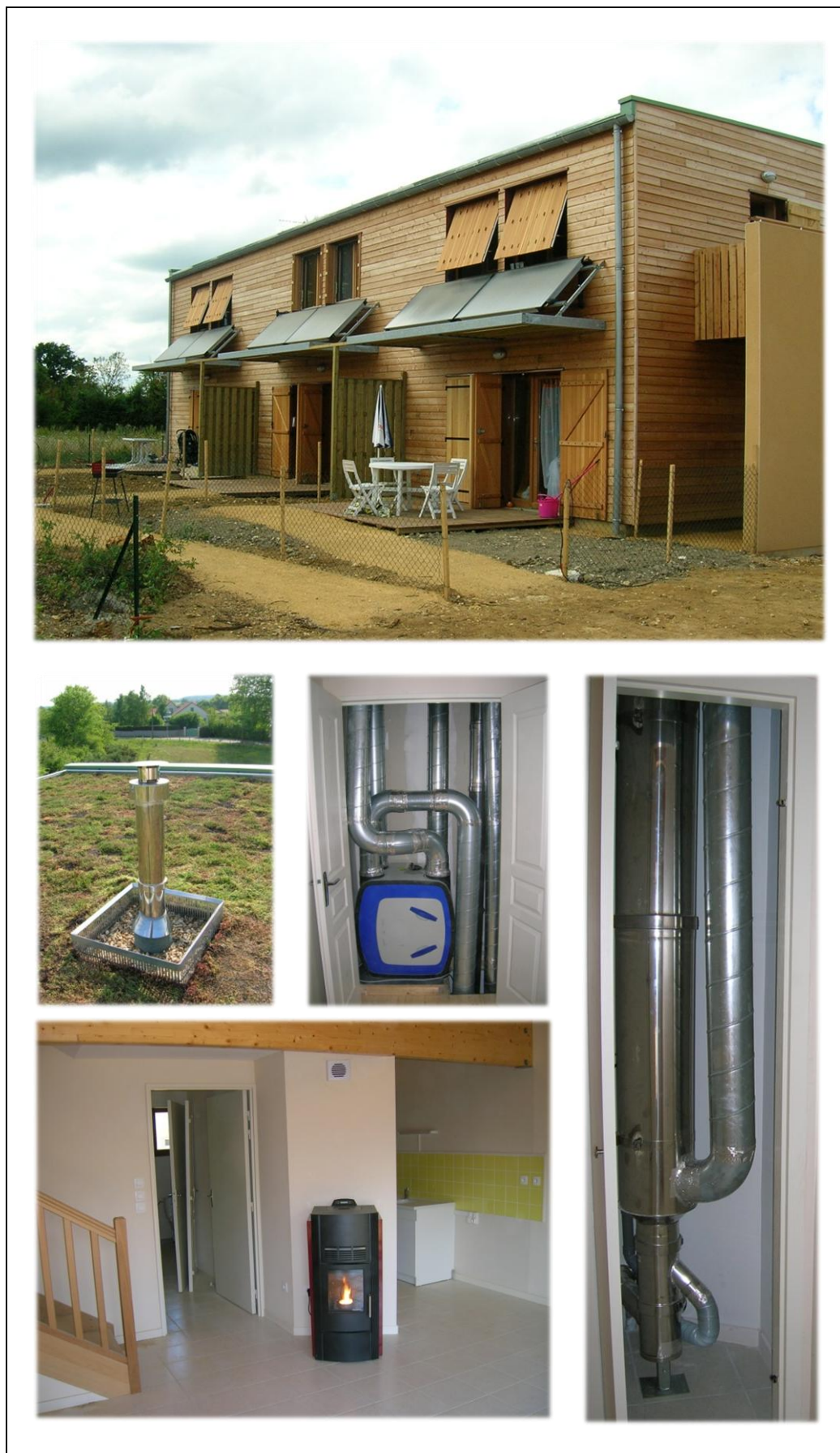
Figure 3.36 : Vue d'un bâtiment et des différents composants du système combiné installé sur site
