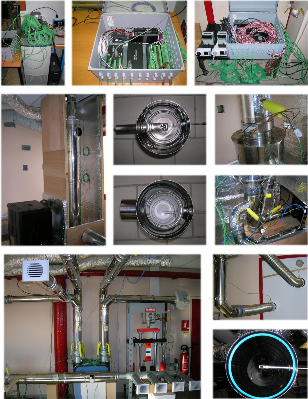
Figure 3.11 : Vues de quelques étapes de la réalisation du banc d'essai sur le système combiné
