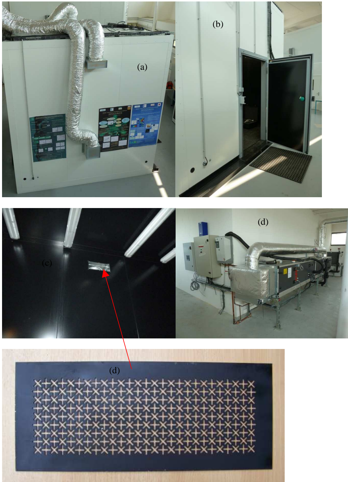
Figure 5.57: (a-d) Cellule de Diffusion de l'Air nouvellement construite au LEPTIAB et sa Centrale de Traitement d'Air; (d) une des grilles lobée à mettre en situation dans la cellule test
