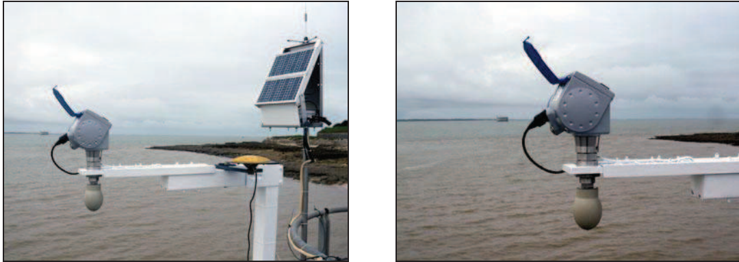
Figure IV-64 : A gauche : télémètre radar alimenté par un panneau solaire sur la jetée Sainte-Catherine de l'île d'Aix. Présence ponctuelle d'un GNSS. A droite : télémètre radar Optiwave, avec capteur à air libre (2011).
