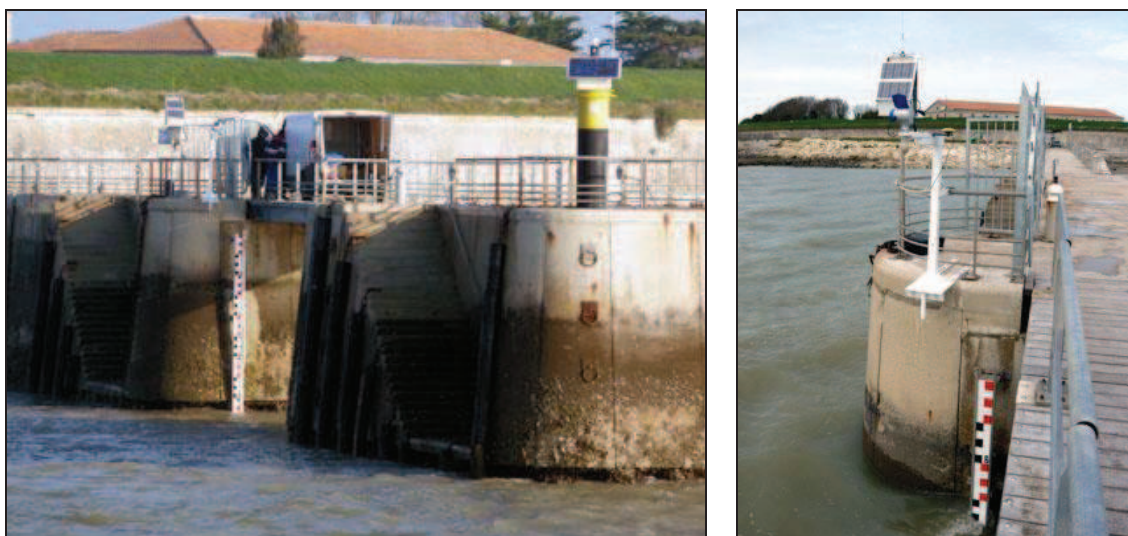
Figure IV-63 : A gauche : emplacement du marégraphe et de l'échelle de marée sur la jetée Sainte-Catherine de l'île d'Aix. A droite : marégraphe déporté de la jetée de 1,5 m (2011).
