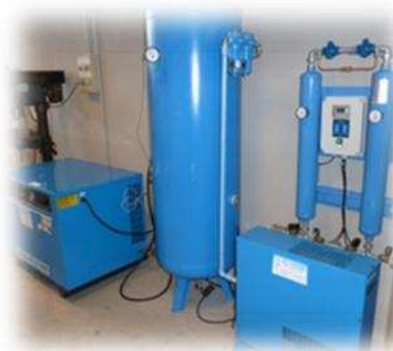
e) Compresseur d'air et circuits de séchage.
